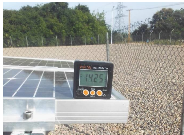
Figure 33: Structure de support PV-S avec un angle d'inclinaison de 14° vers le sud / PV-S support structure with 14° tilt angle towards South.
