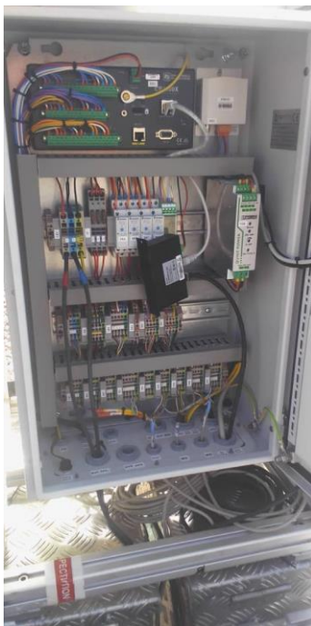
Figure 30: Intérieur du boîtier de contrôle / Control box interior.
