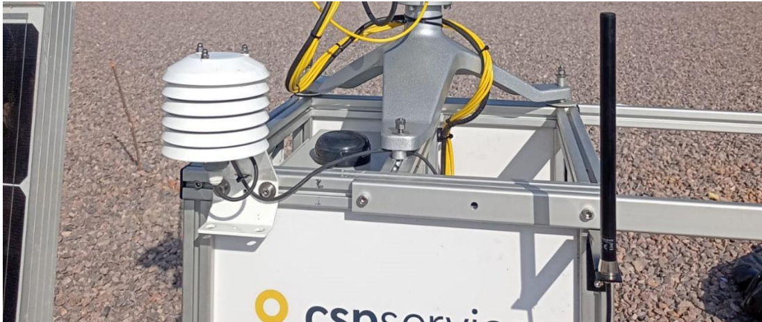
Figure 29: Capteur T/RH et antenne du modem / T/RH sensor and modem antenna
