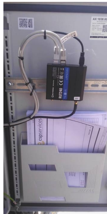
Figure 31: Routeur LTE / LTE router
