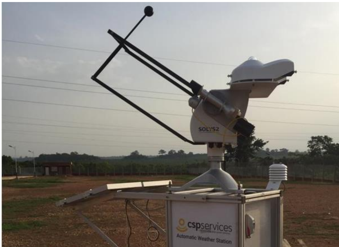
Figure 36 : Tracker solaire, capteurs et panneaux PV du système de mesure de salissure (PV-S) / Solar tracker, sensors and PV panels of soiling measurement system (PV-S).
