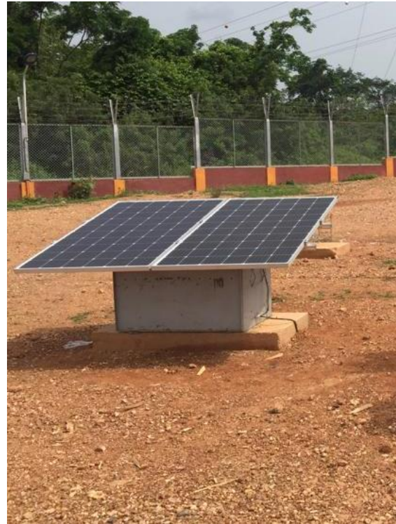
Figure 35 : Système d'alimentation / Power supply PV system
