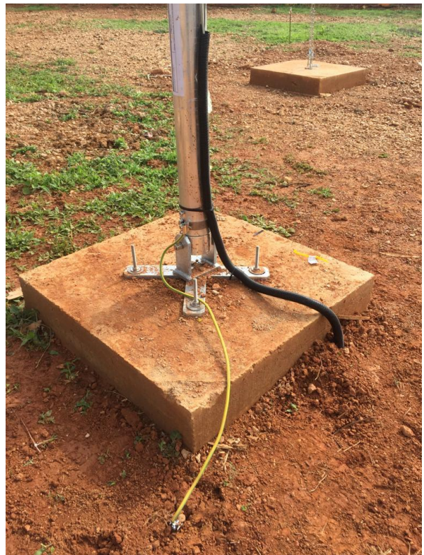
Figure 12 : Fondations du mât du vent, câble de terre fixé au boulon de terre, tube de protection pour les câbles du mât du vent / Wind mast foundations, ground cable fixed to ground bolt, protective tube for wind mast cables
