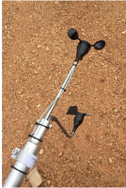
Figure 14: Capteurs de vent installés sur le mât du vent / Wind sensors installed on wind mast
