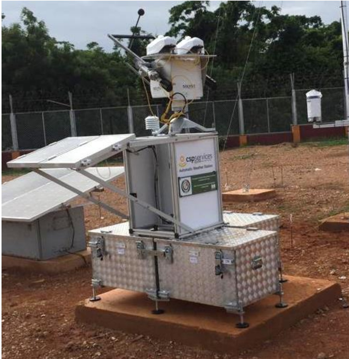
Figure 37 : Structure de montage, suiveur solaire, capteurs et boîtier de contrôle avec le logo WAPP / Mounting structure, solar tracker, sensors and control box with WAPP logo.
