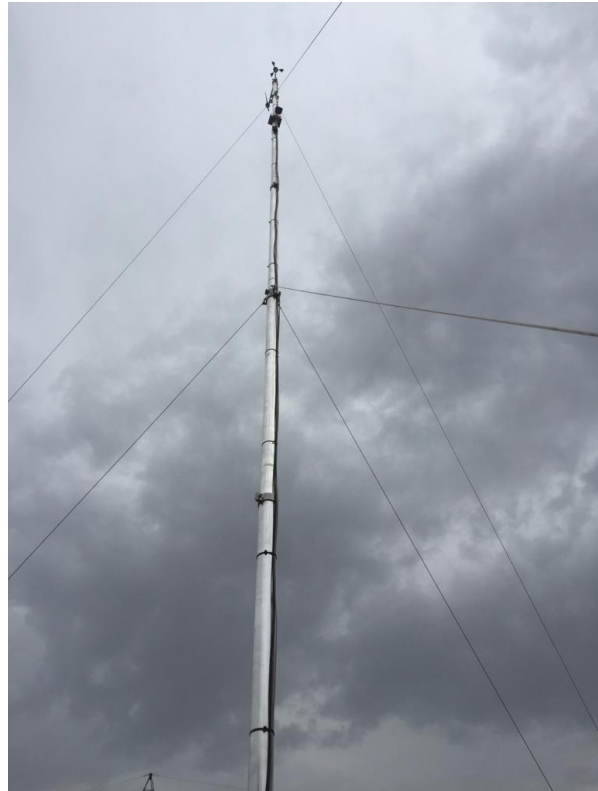
Figure 49: Capteurs de vent installés sur le mât du vent / Wind sensors installed on wind mast.
