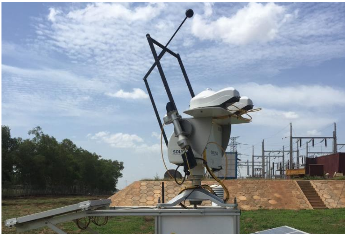
Figure 95: Tracker solaire, capteurs et panneaux PV du système de mesure de salissure (PV-S) / Solar tracker, sensors and PV panels of soiling measurement system (PV-S).
