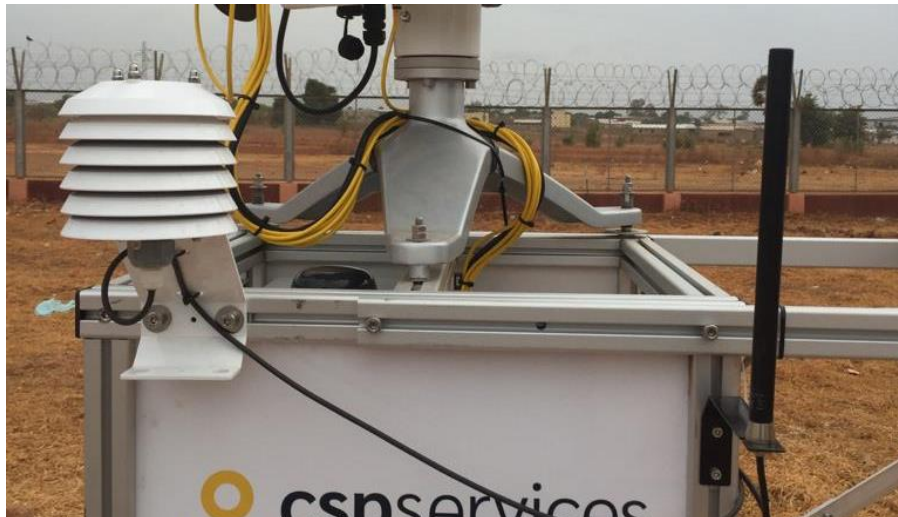
Figure 64: Capteur T/RH et antenne du modem / T/RH sensor and modem antenna.
