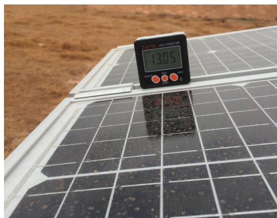
Figure 68: Structure de support PV-S avec un angle d'inclinaison de 13° vers le sud / PV-S support structure with 13° tilt angle towards south.
