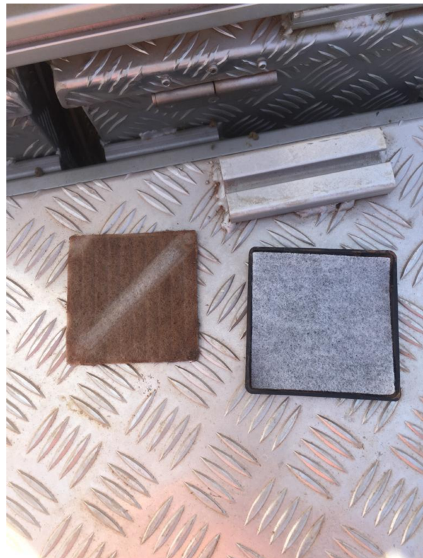
Figure 88: Filtres de l'unité de ventilation après leur remplacement / Ventilation unit filters after replacement.
