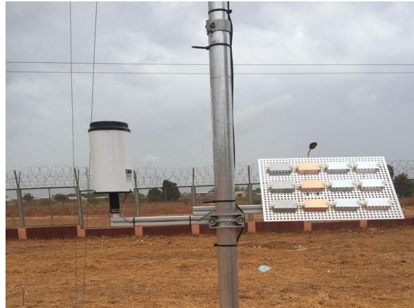
Figure 24: Capteur de pluie et échantillonneur de corrosion / Rain sensor and corrosion sampler
