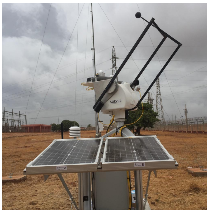
Figure 36 : Tracker solaire, capteurs et panneaux PV du système de mesure de salissure (PV-S) / Solar tracker, sensors and PV panels of soiling measurement system (PV-S).
