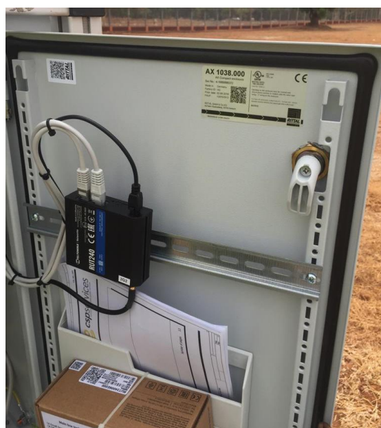
Figure 31: Routeur LTE / LTE router
