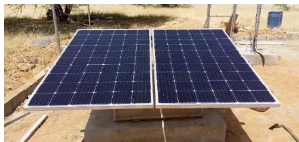
Figure 70 : Système d'alimentation / Power supply PV system.
