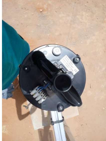
Figure 86: Nettoyage et mise à niveau du capteur de pluie / Rain sensor cleaning and levelling.
