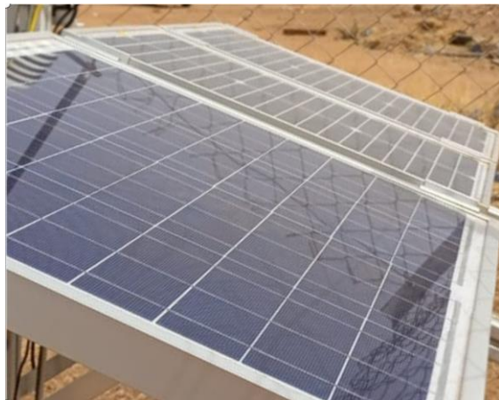
Figure 76: Panneau d'alimentation (avant), panneaux d'encrassement PV (arrière) / Power supply panel (front), PV soiling panels (back).
