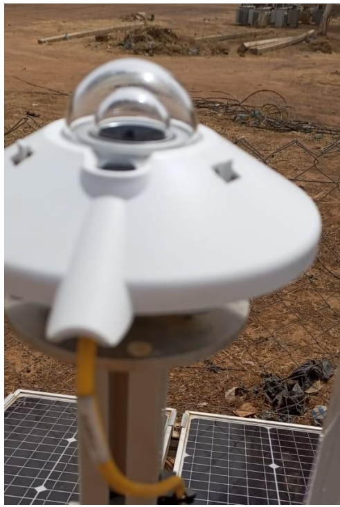
Figure 72 : Pyranomètre CMP10 installé, mis à niveau et connecté / CMP10 pyranometer installed, levelled and connected.
