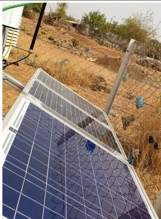
Figure 77: Panneau d'alimentation, panneaux d'encrassement PV) / Power supply panel, PV soiling panels.
