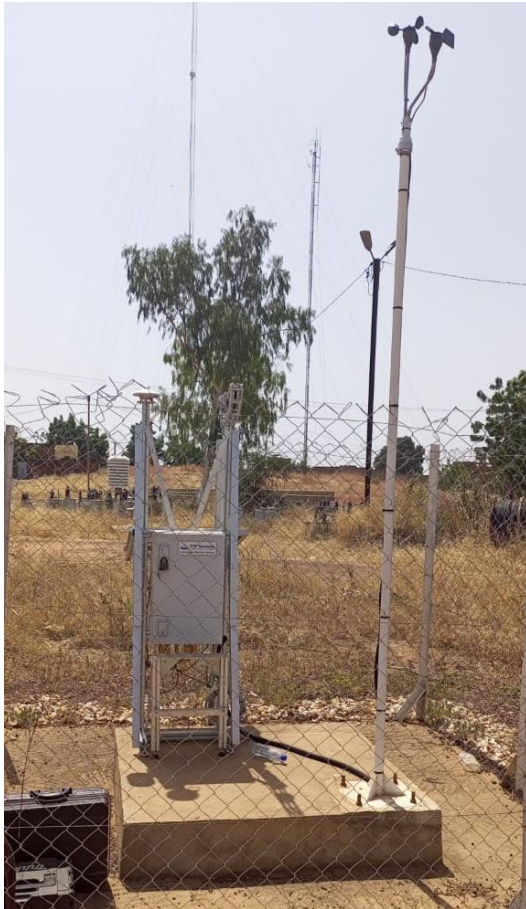
Figure 49: Vue d'ensemble de la station de mesure / Measurement station overview.
