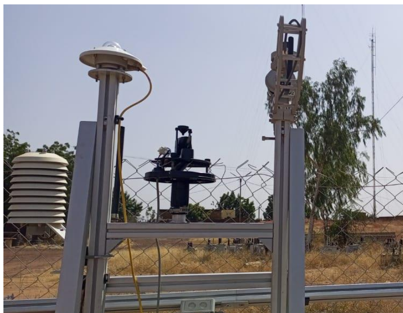
Figure 51: Installation du capteur de pluie sur la structure de montage / Rain sensor installation on mounting structure.
