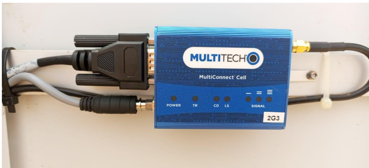
Figure 75: Modem avec antenne, câbles de communication et d'alimentation / Modem with antenna, data and power supply cables.
