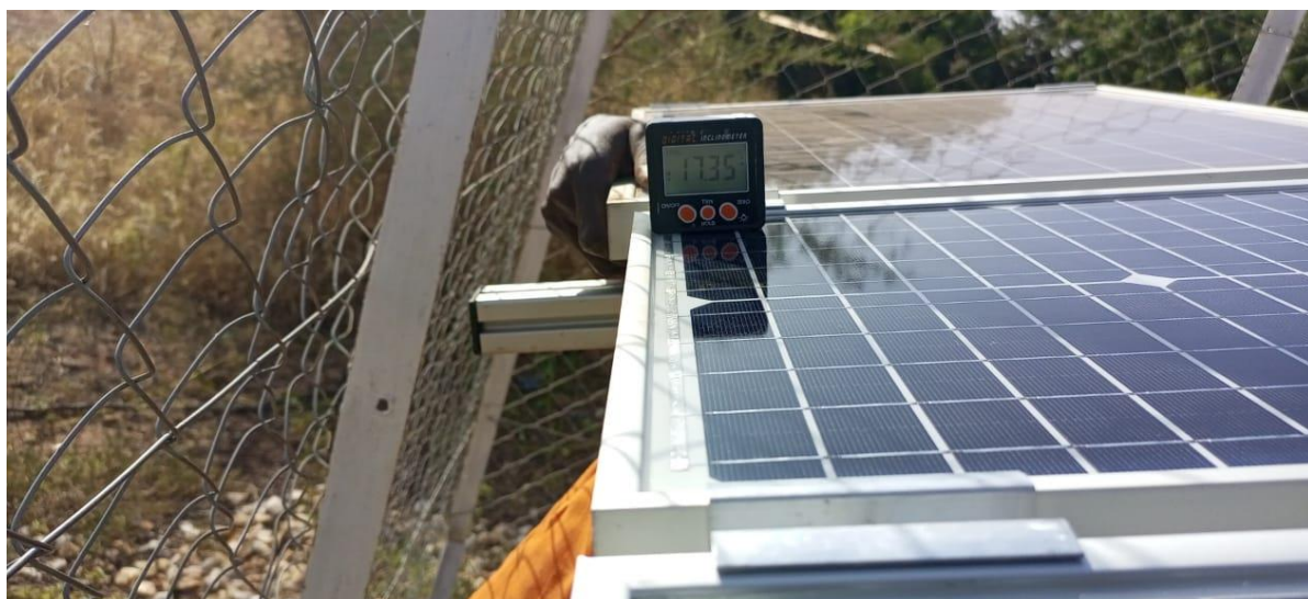
Figure 56: Contrôle de l'inclinaison des modules PV-S / PV-S module inclination check.
