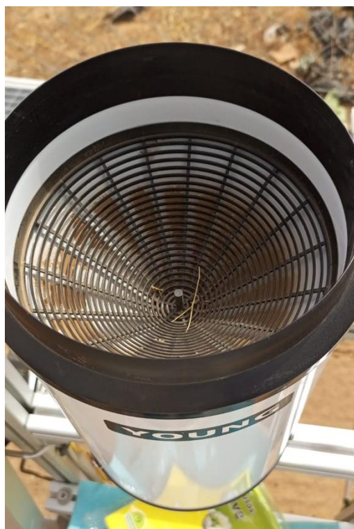
Figure 78: Capteur de pluie avant le nettoyage / Rain sensor before cleaning.
