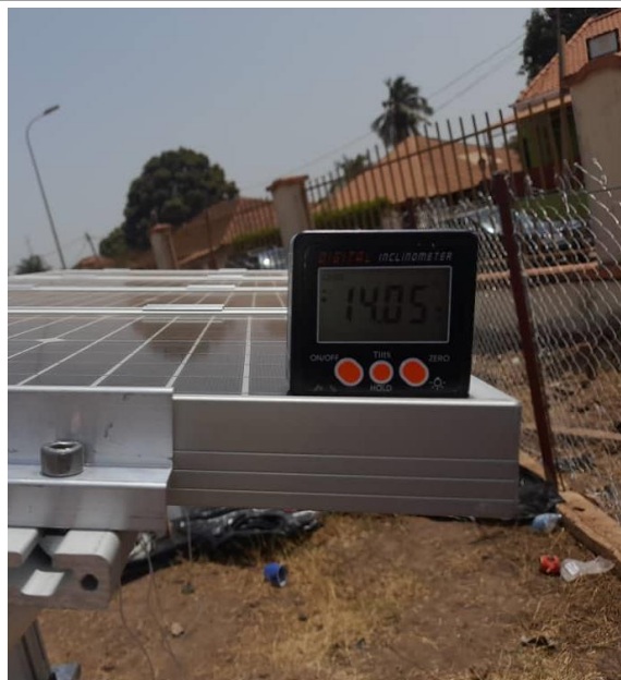
Figure 33: Structure de support PV-S avec un angle d'inclinaison de 14° vers le sud / PV-S support structure with 14° tilt angle towards South.
