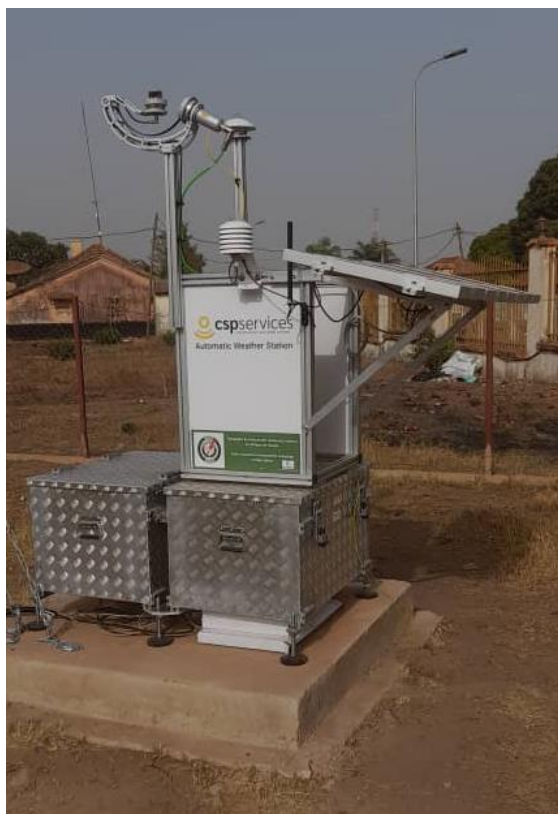
Figure 34 : Structure de montage, capteurs et boîtier de contrôle avec le logo WAPP / Mounting structure, sensors and control box with WAPP logo
