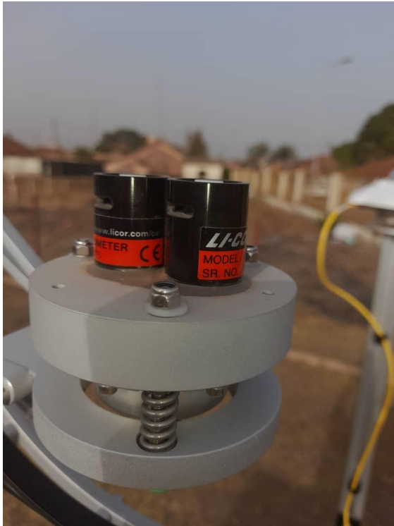
Figure 21 : Unité PU avec Licor installé / PU Unit with Licor installed
