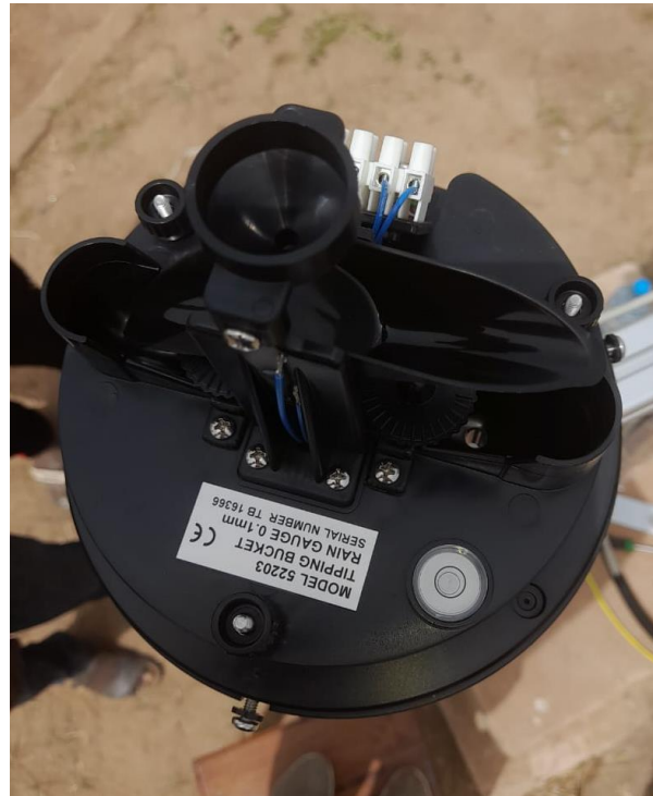
Figure 26: Nivellement du capteur de pluie / Rain sensor levelling
