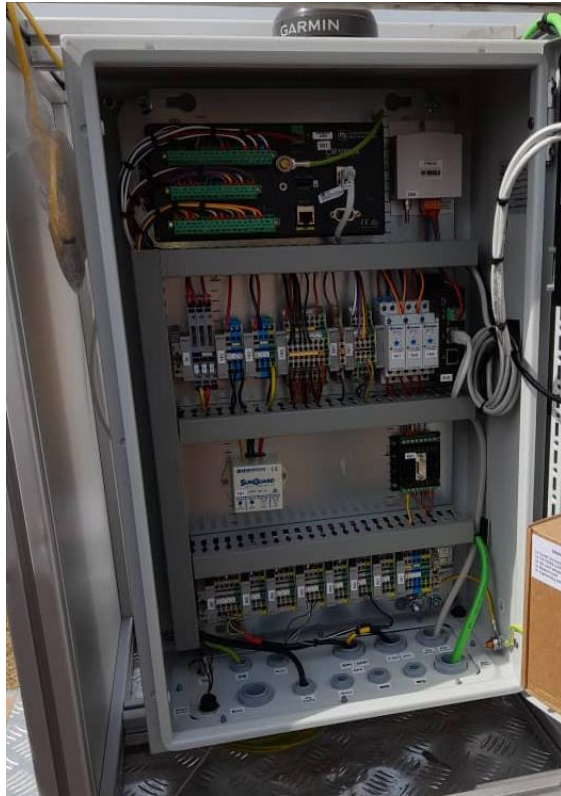
Figure 29: Intérieur du boîtier de contrôle / Control box interior.
