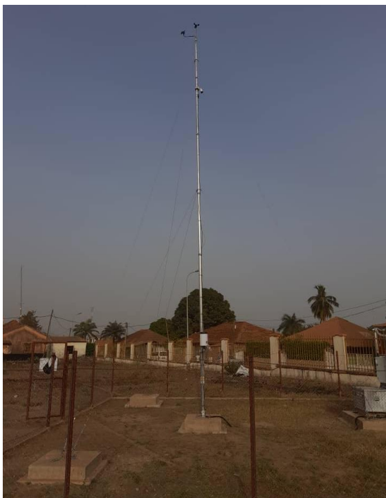
Figure 15: Mât du vent installé capteur de direction du vent orienté vers le nord / Wind mast erected; wind direction sensor orientated to North
