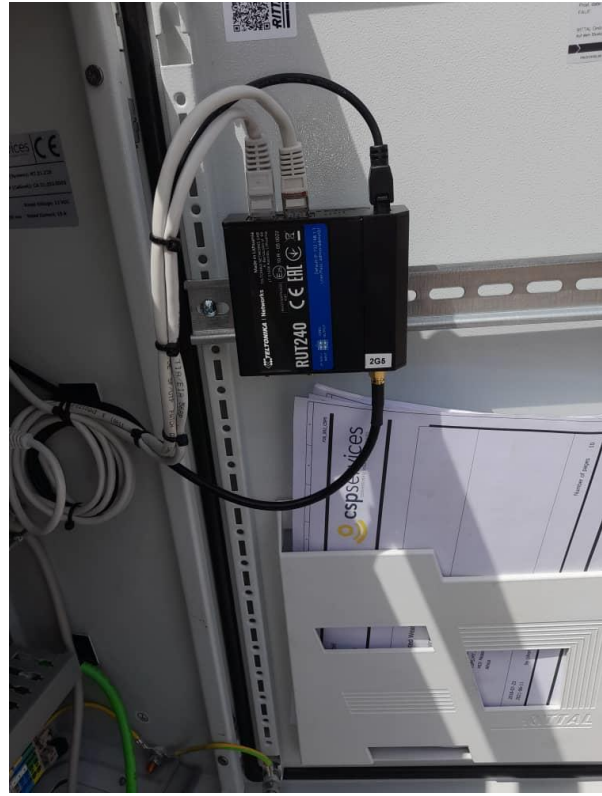
Figure 30: Routeur LTE / LTE router
