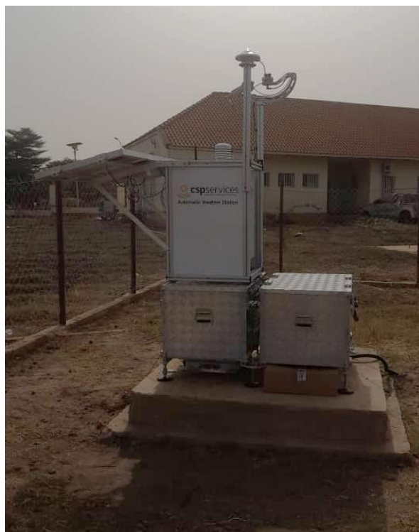
Figure 35 : Structure de montage, capteurs et boîtier de contrôle / Mounting structure, sensors and control box.
