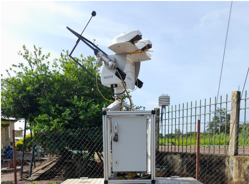
Figure 91 : Tracker solaire, capteurs et panneaux PV du système de mesure de salissure (PV-S) / Solar tracker, sensors and PV panels of soiling measurement system (PV-S).
