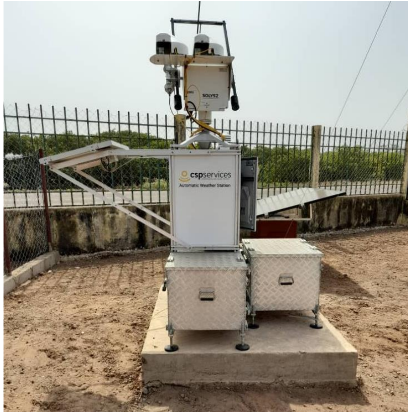
Figure 72 : Structure de montage, suiveur solaire, capteurs et boîtier de contrôle / Mounting structure, solar tracker, sensors and control box.
