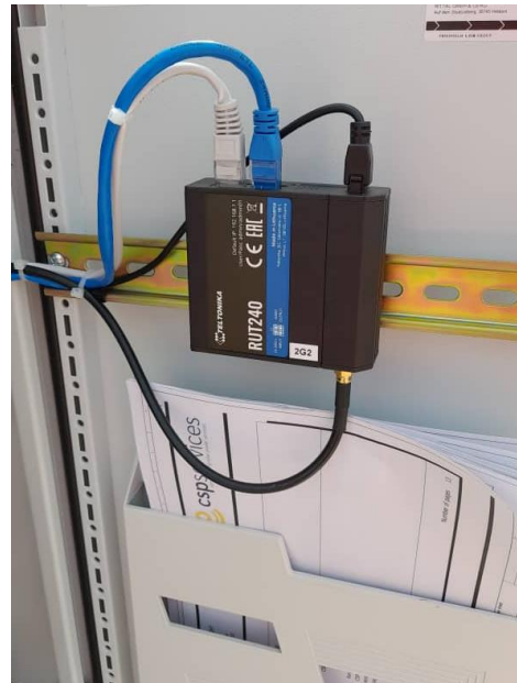
Figure 31: Routeur LTE / LTE router
