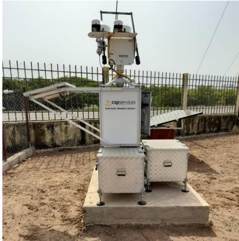
Figure 37 : Structure de montage, suiveur solaire, capteurs et boîtier de contrôle / Mounting structure, solar tracker, sensors and control box.
