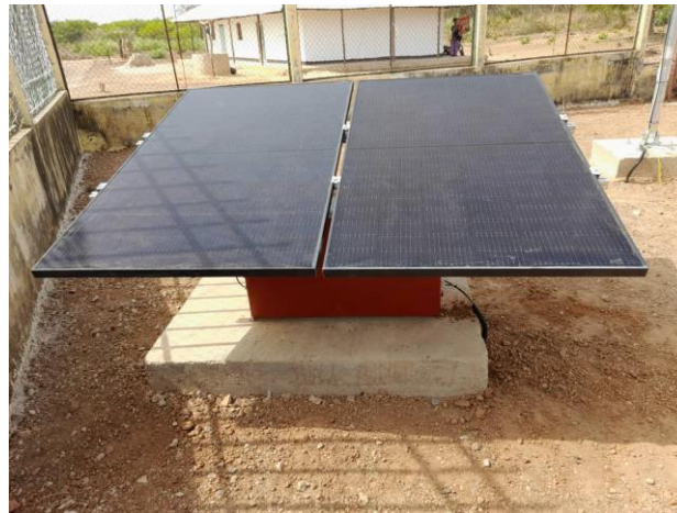
Figure 35 : Système d'alimentation / Power supply PV system
