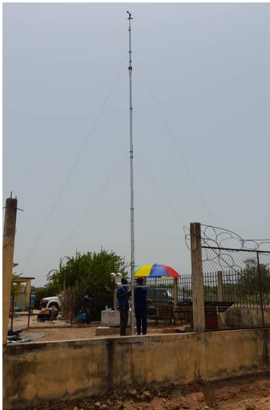
Figure 15: Mât du vent installé capteur de direction du vent orienté vers le nord / Wind mast erected; wind direction sensor orientated to North
