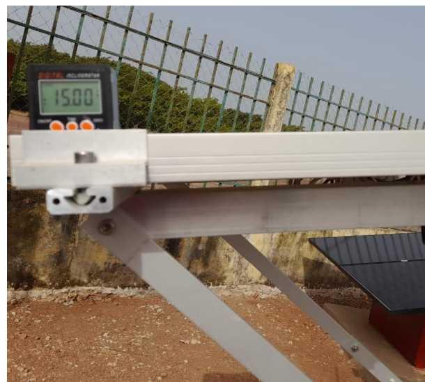
Figure 33: Structure de support PV-S avec un angle d'inclinaison de 11° vers le sud / PV-S support structure with 11° tilt angle towards South.
