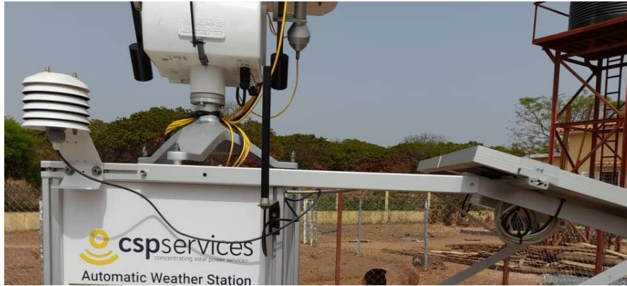
Figure 29: Capteur T/RH et antenne du modem / T/RH sensor and modem antenna
