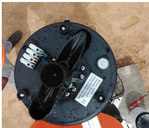
Figure 84: Nettoyage et mise à niveau du capteur de pluie / Rain sensor cleaning and levelling.
