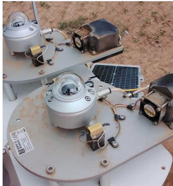
Figure 78: Pyranomètres et ventilations sur le tracker solaire / Pyranometers and ventilation units on solar tracker.
