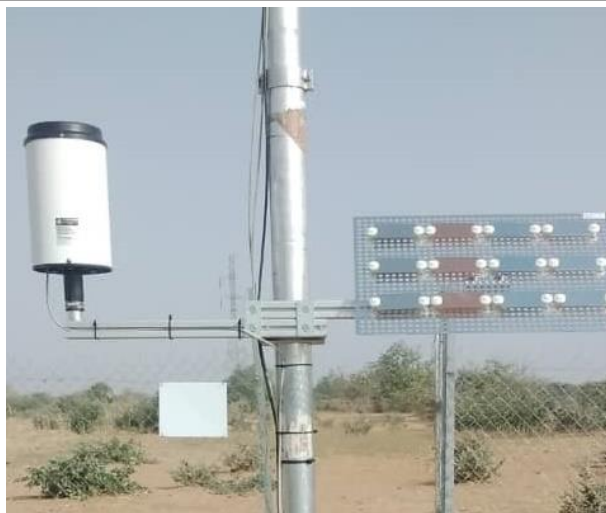
Figure 59: Capteur de pluie et échantillonneur de corrosion / Rain sensor and corrosion sampler.
