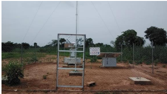
Figure 77: Vue d'ensemble de la station de mesure / Measurement station overview.
