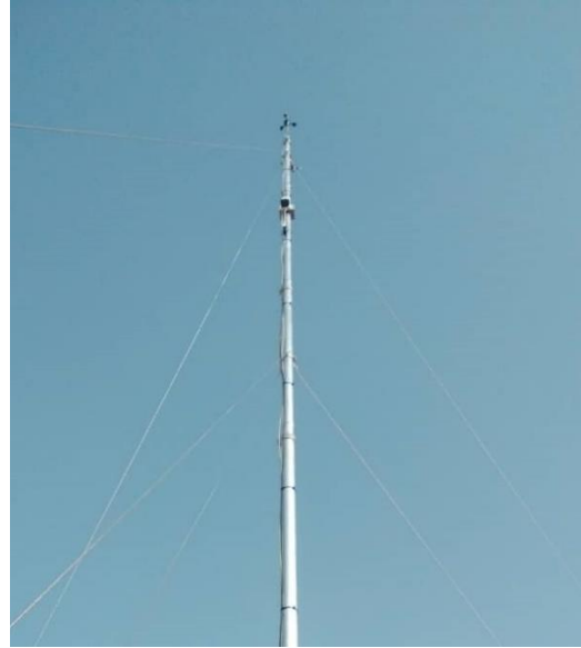
Figure 49: Capteurs de vent installés sur le mât du vent / Wind sensors installed on wind mast.
