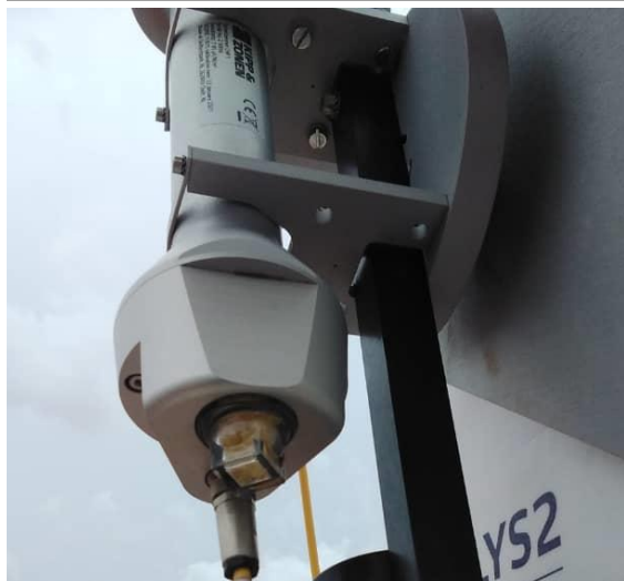
Figure 81 : Changement du dessiccant de pyréliomètre / Change of pyrhelimeter desiccant.
