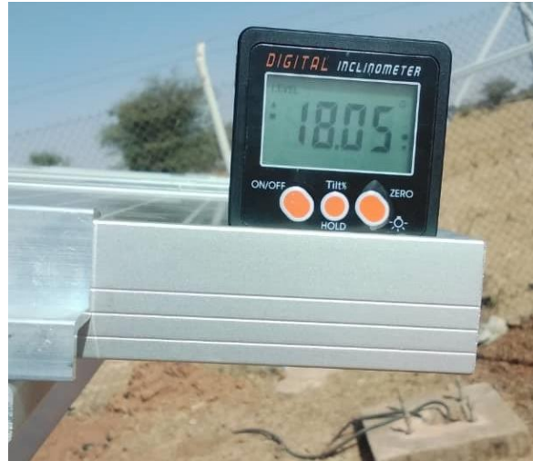
Figure 33: Structure de support PV-S avec un angle d'inclinaison de 18° vers le sud / PV-S support structure with 18° tilt angle towards South.
