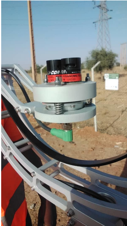
Figure 21 : Unité PU avec Licor installé / PU Unit with Licor installed
