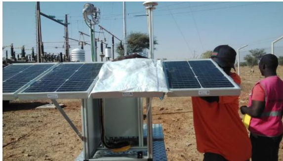
Figure 32: Test du système de PVS (module A) / Test of PVS system (A module)
