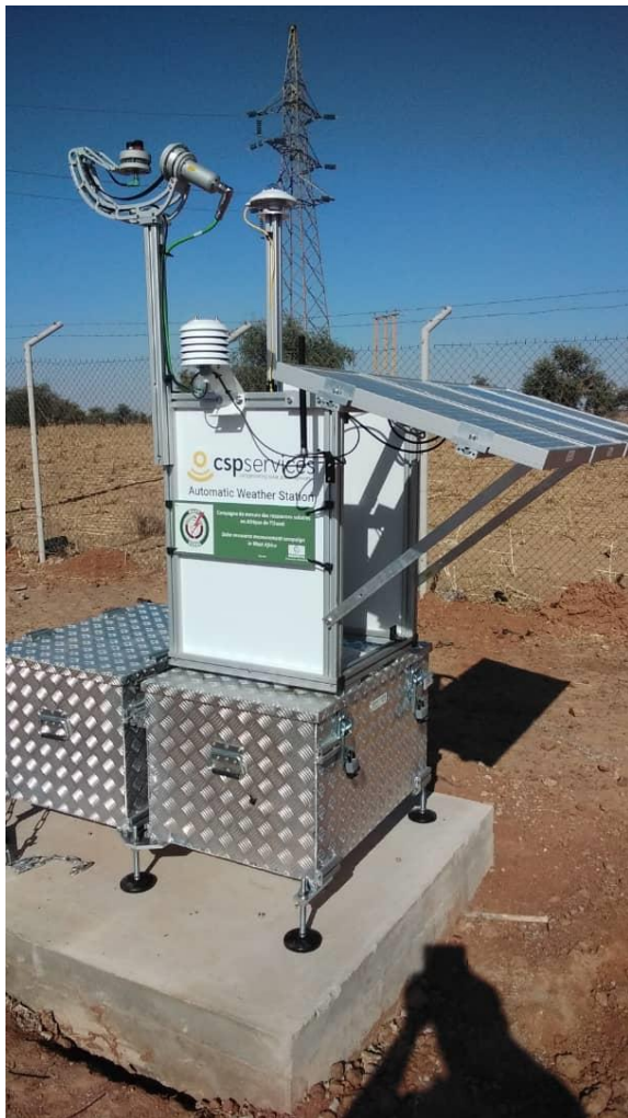
Figure 34 : Structure de montage, capteurs et boîtier de contrôle avec le logo WAPP / Mounting structure, sensors and control box with WAPP logo
