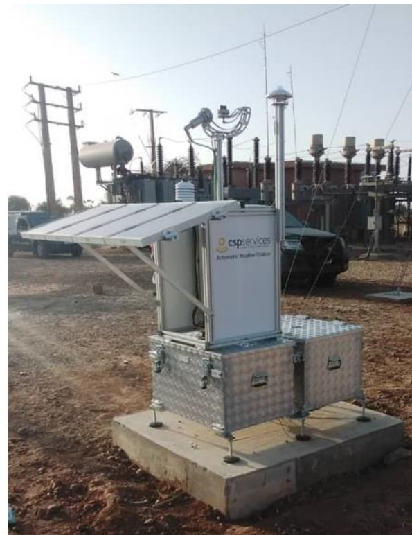
Figure 35 : Structure de montage, capteurs et boîtier de contrôle / Mounting structure, sensors and control box.
