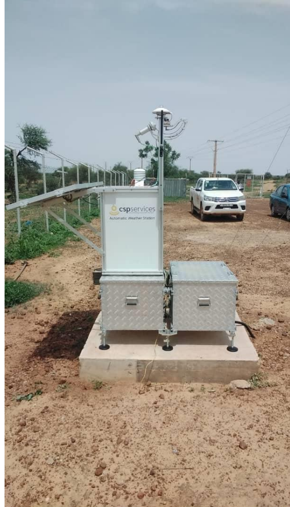
Figure 75: Vue d'ensemble de la station de mesure / Measurement station overview.
