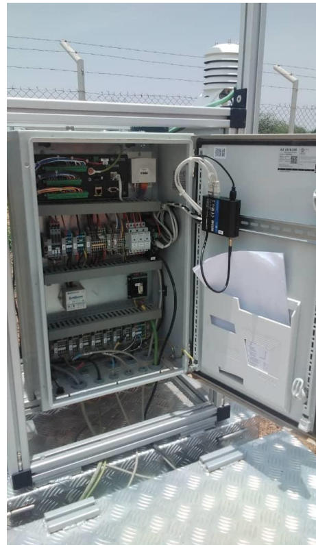
Figure 87: Intérieur de l'armoire principale / Interior of main cabinet.
