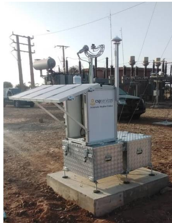
Figure 71: Structure de montage, capteurs et boîtier de contrôle / Mounting structure, sensors and control box.
