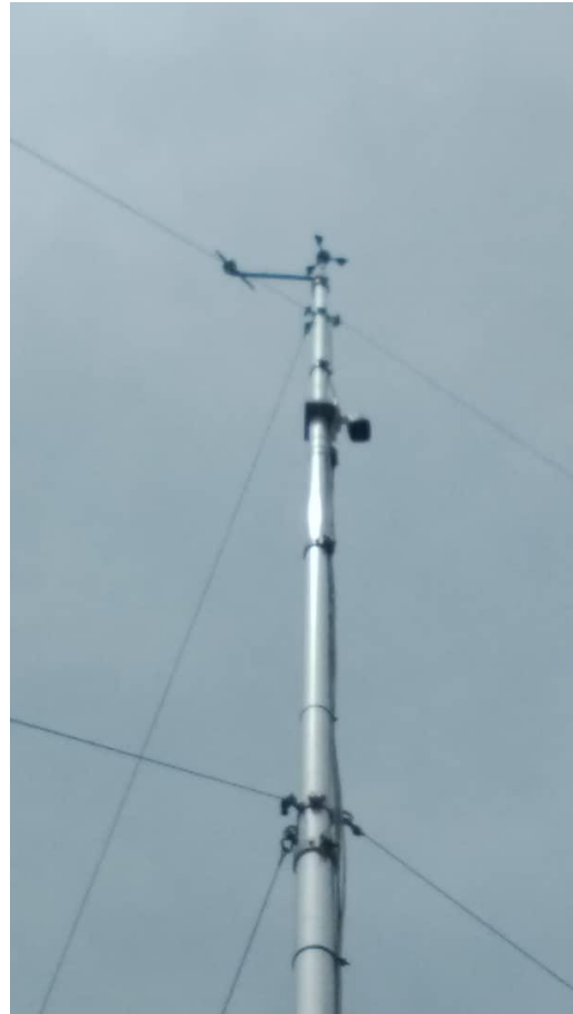
Figure 83: Capteurs de vent, caméra de surveillance / Wind sensors, surveillance camera.
