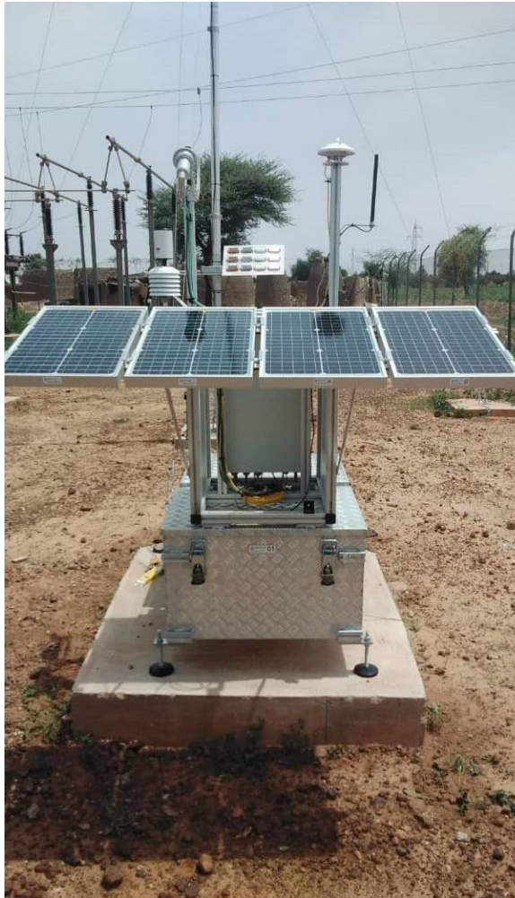
Figure 74: Vue d'ensemble de la station de mesure / Measurement station overview.
