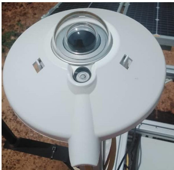
Figure 76: Nivellement pyranomètre / Pyranometer leveling.
