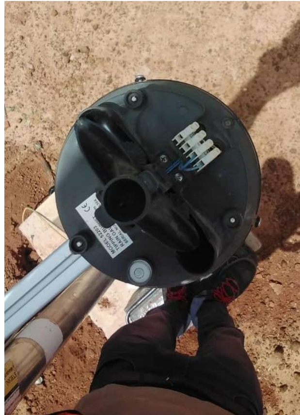
Figure 79: Mise à niveau pluviomètre / Rain sensor leveling.
