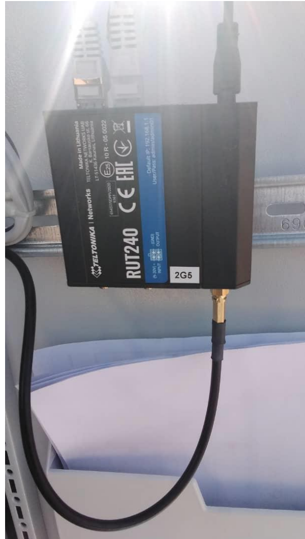
Figure 66: Routeur LTE / LTE router.
