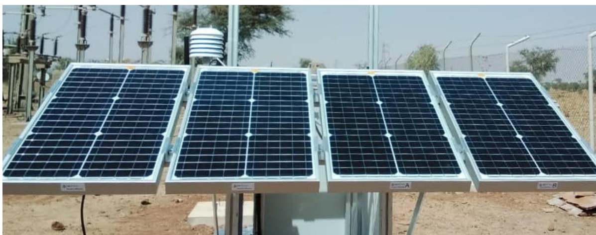
Figure 67: Modules d'alimentation électrique (gauche), modules A et B du système d'encrassement PV-S (droite) / Power supply modules (left), PV-S soiling system modules (right).
