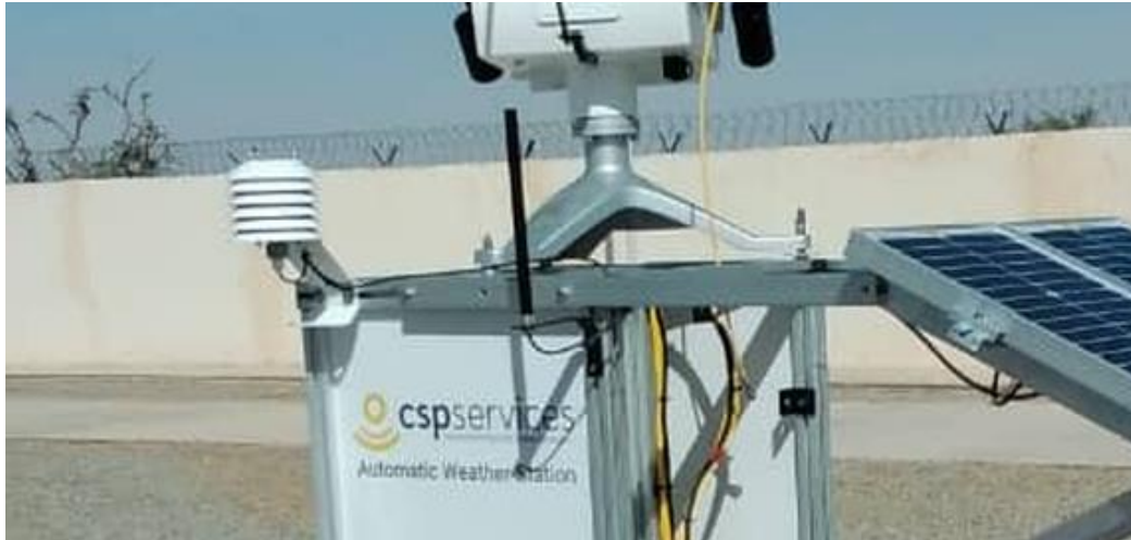
Figure 29: Capteur T/RH et antenne du modem / T/RH sensor and modem antenna
