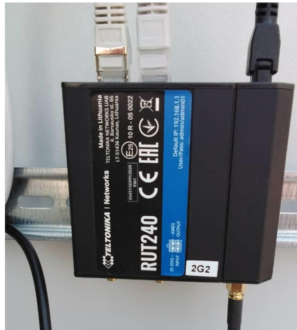
Figure 31: Routeur LTE / LTE router
