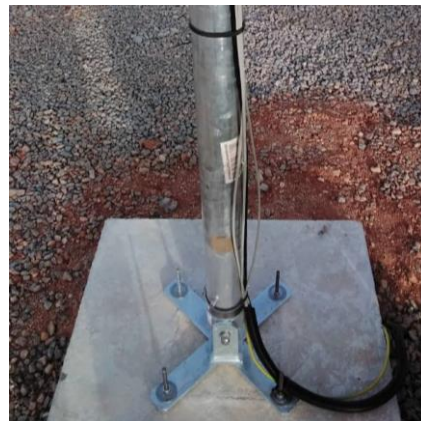
Figure 12 : Fondations du mât du vent, câble de terre fixé au boulon de terre, tube de protection pour les câbles du mât du vent / Wind mast foundations, ground cable fixed to ground bolt, protective tube for wind mast cables
