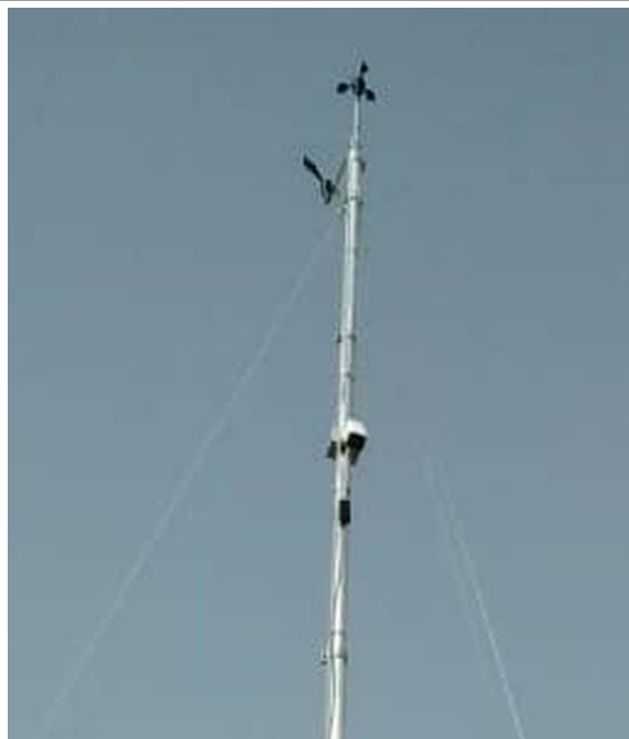
Figure 14: Capteurs de vent installés sur le mât du vent / Wind sensors installed on wind mast
