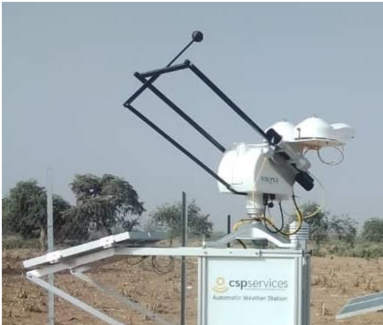
Figure 36 : Tracker solaire, capteurs et panneaux PV du système de mesure de salissure (PV-S) / Solar tracker, sensors and PV panels of soiling measurement system (PV-S).
