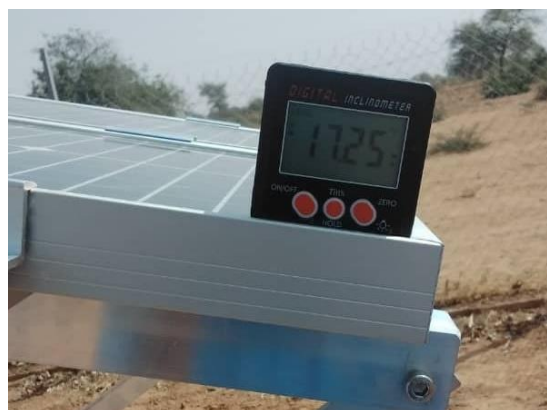
Figure 33: Structure de support PV-S avec un angle d'inclinaison de 17° vers le sud / PV-S support structure with 17° tilt angle towards South.
