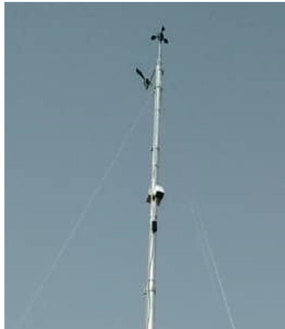
Figure 49: Capteurs de vent installés sur le mât du vent / Wind sensors installed on wind mast.
