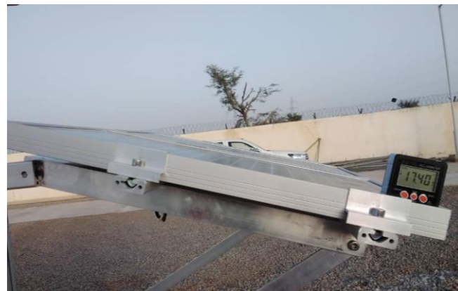
Figure 68: Structure de support PV-S avec un angle d'inclinaison de 18° vers le sud / PV-S support structure with 18° tilt angle towards south.
