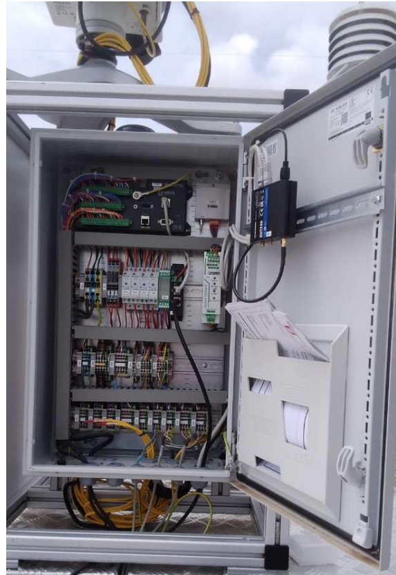
Figure 90 : Intérieur de l'armoire principale / Interior of main cabinet.
