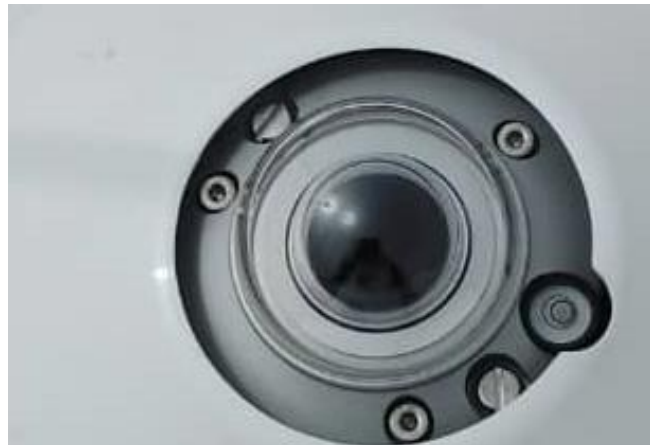
Figure 53: Mise à niveau du pyranomètre CMP10 (GHI) / CMP10 pyranometer leveling (GHI).
