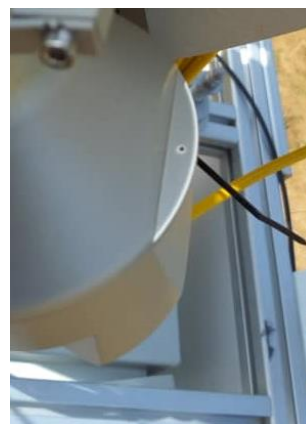
Figure 63 : Alignement du pyrhéliomètre / Pyrhelimeter alignment.
