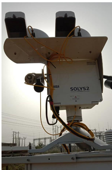
Figure 78: Conduite des câbles du tracker solaire après ajustement / Solar tracker cable guiding after adjustment.
