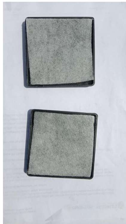
Figure 87: Filtres de l'unité de ventilation après leur remplacement / Ventilation unit filters after replacement.
