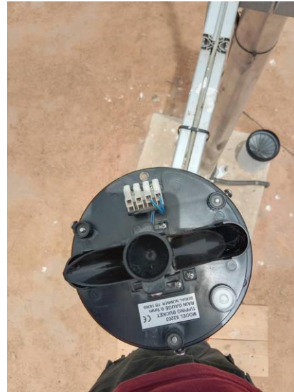
Figure 89: Nettoyage et mise à niveau du capteur de pluie / Rain sensor cleaning and levelling.
