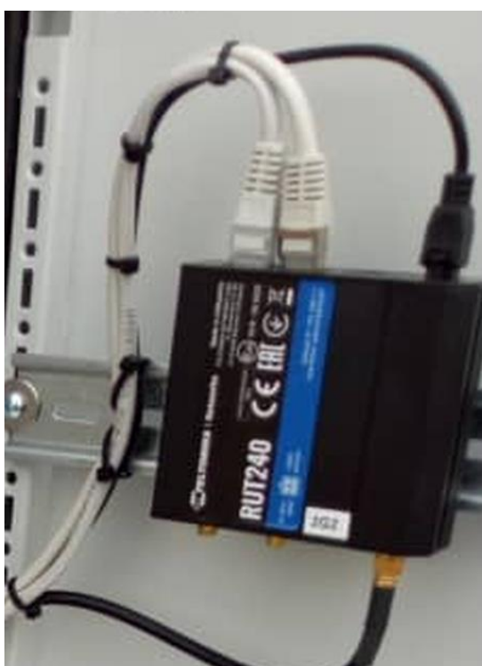
Figure 66: Routeur LTE / LTE router.
