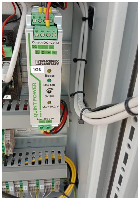
Figure 97: Contrôle de l'état de l'alimentation électrique / Power supply status check.
