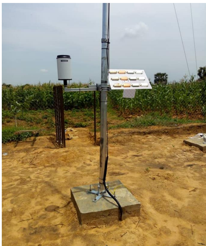
Figure 73: Base de mât de mesure du vent, capteur de pluie et échantillonneur de corrosion / Wind mast foot, rain sensor and corrosion sampler.
