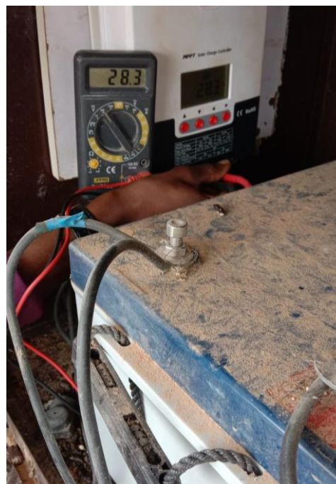
Figure 98: Contrôle de l'état du régulateur de charge / Solar charge controller status check.
