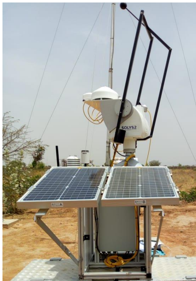
Figure 94 : Tracker solaire, capteurs et panneaux PV du système de mesure de salissure (PV-S) / Solar tracker, sensors and PV panels of soiling measurement system (PV-S).
