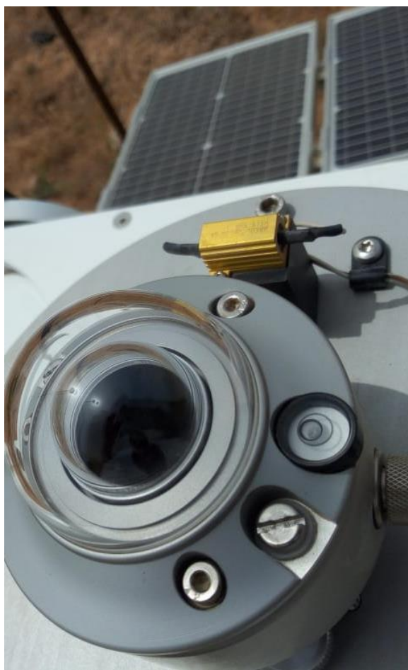
Figure 82: Mise à niveau du pyranomètre CMP10 (GHI) / CMP10 pyranometer leveling (DHI).
