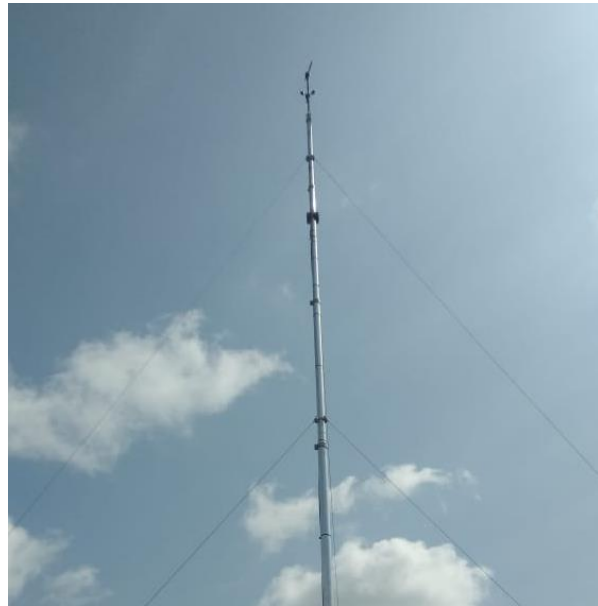
Figure 14: Capteurs de vent installés sur le mât du vent / Wind sensors installed on wind mast
