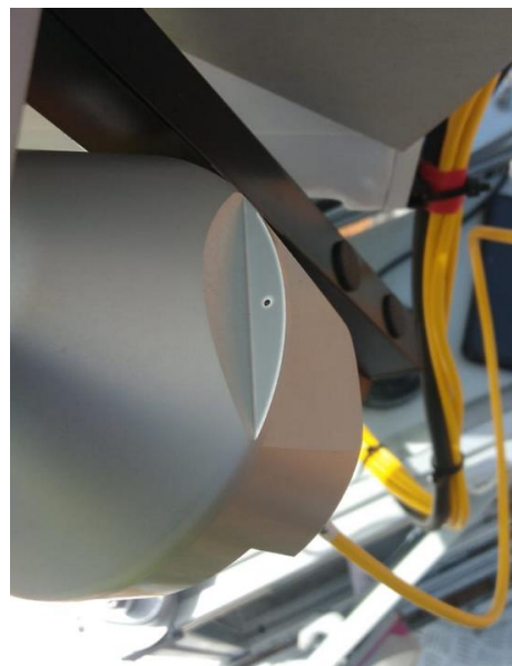
Figure 28 : Alignement du pyrhéliomètre / Pyrheliometer alignment
