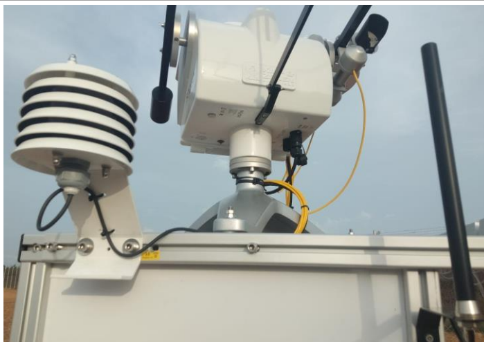
Figure 29: Capteur T/RH et antenne du modem / T/RH sensor and modem antenna
