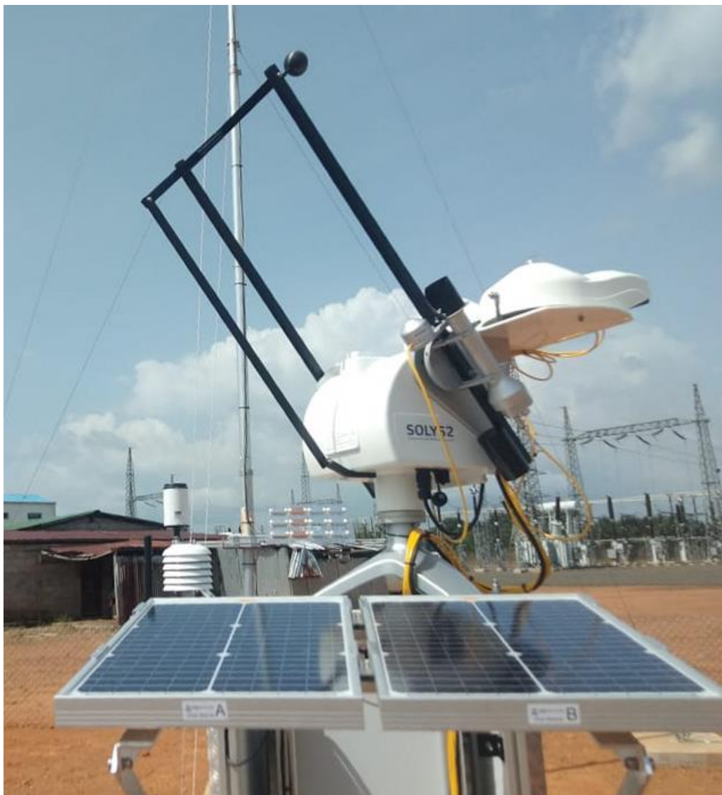
Figure 36 : Tracker solaire, capteurs et panneaux PV du système de mesure de salissure (PV-S) / Solar tracker, sensors and PV panels of soiling measurement system (PV-S).
