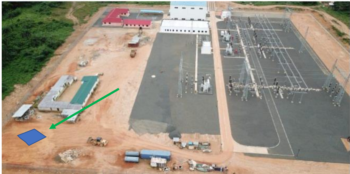
Figure 2: Emplacement dans la sous-station de TRANSCO CLSG à Buchanan (pas d'image satellitaire disponible au moment de la rédaction de ce rapport) / Location at the TRANSCO CLSG substation in Buchanan (no satellite image available at the time of this report) Source : https://www.transcoclsq.org .
