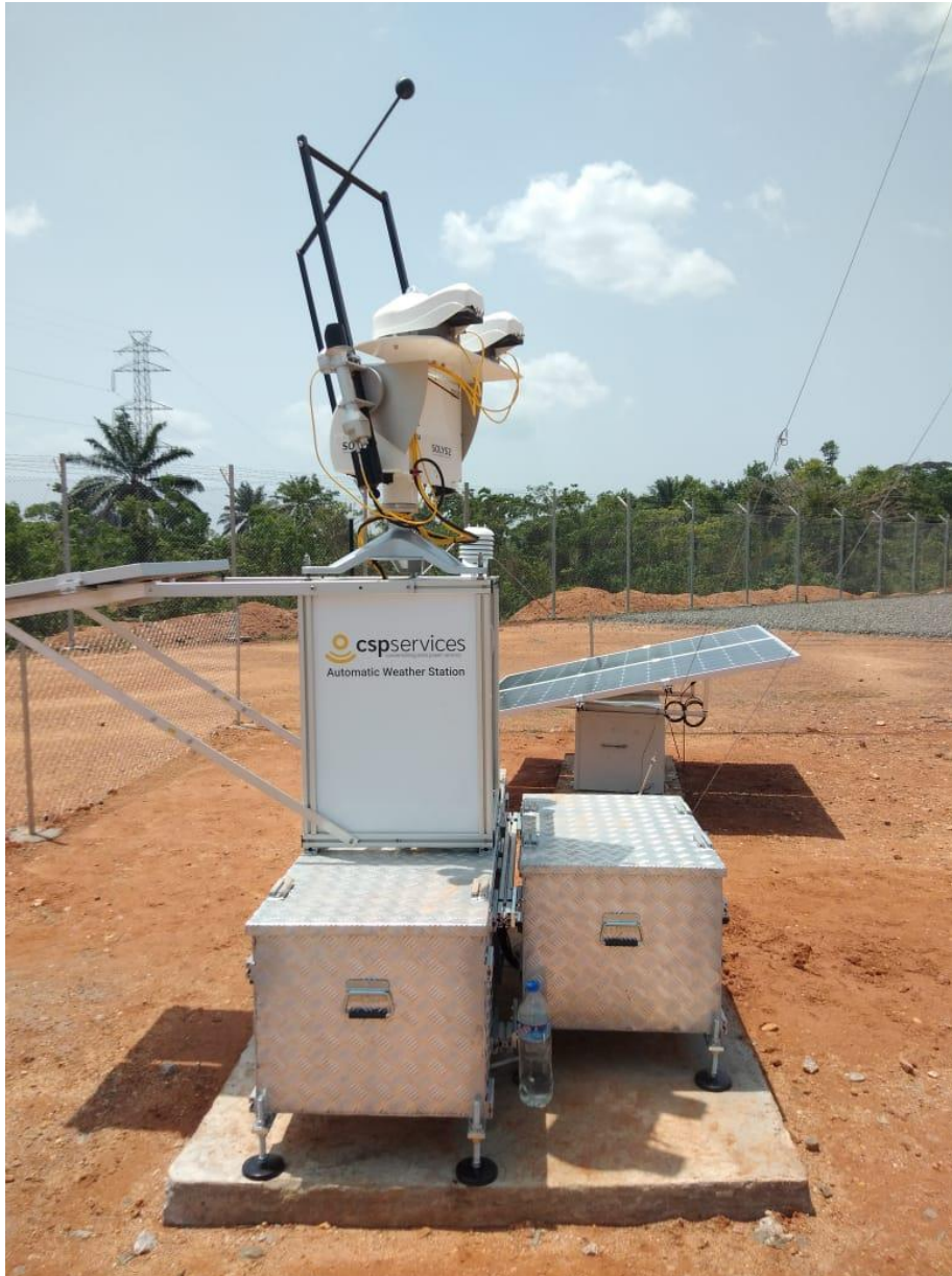
Figure 72 : Structure de montage, suiveur solaire, capteurs et boîtier de contrôle / Mounting structure, solar tracker, sensors and control box.
