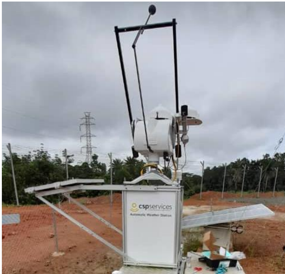
Figure 89 : Tracker solaire, capteurs et panneaux PV du système de mesure de salissure (PV-S) / Solar tracker, sensors and PV panels of soiling measurement system (PV-S).
