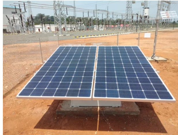
Figure 70 : Système d'alimentation / Power supply PV system.
