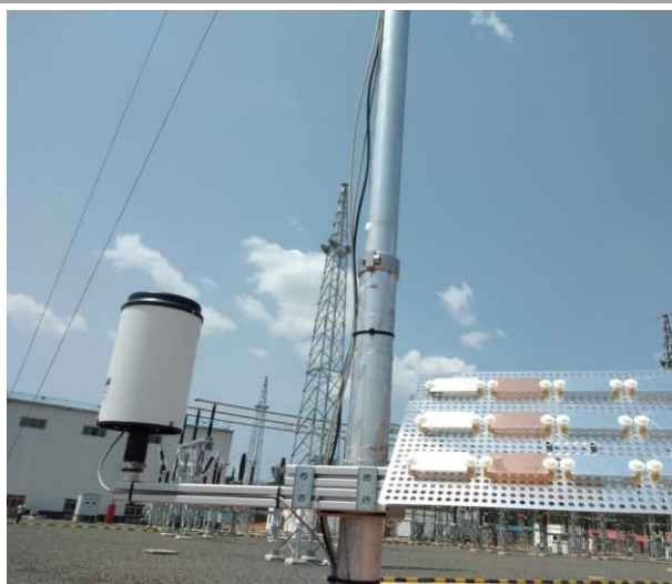
Figure 59: Capteur de pluie et échantillonneur de corrosion / Rain sensor and corrosion sampler.
