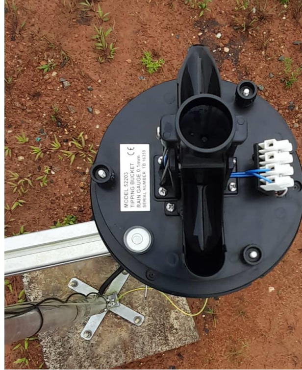
Figure 84: Mise à niveau du capteur de pluie / Rain sensor levelling.
