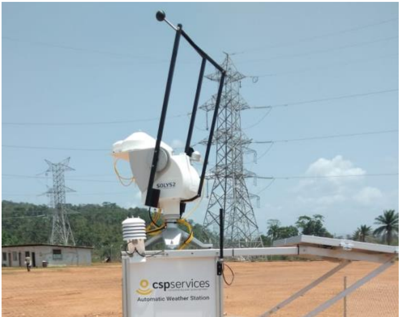
Figure 71 : Tracker solaire, capteurs et panneaux PV du système de mesure de salissure (PV-S) / Solar tracker, sensors and PV panels of soiling measurement system (PV-S).
