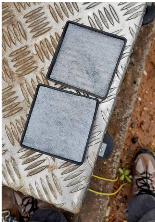
Figure 82: Filtres de l'unité de ventilation après leur remplacement / Ventilation unit filters after replacement.
