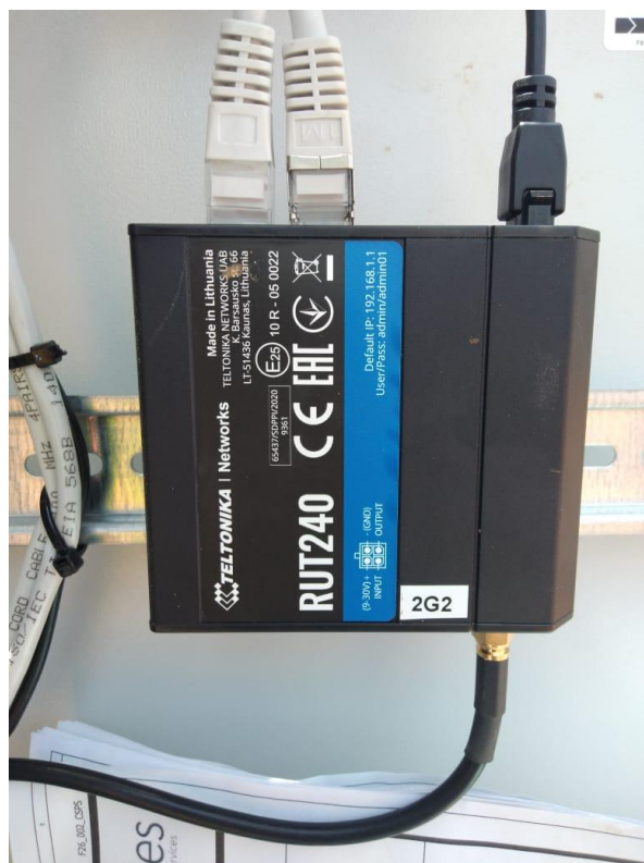
Figure 66: Routeur LTE / LTE router.
