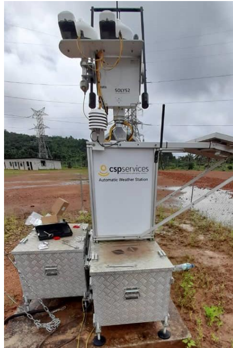
Figure 90 : Structure de montage, tracker solaire, capteurs et boîtier de contrôle / Mounting structure, solar tracker, sensors and control box.
