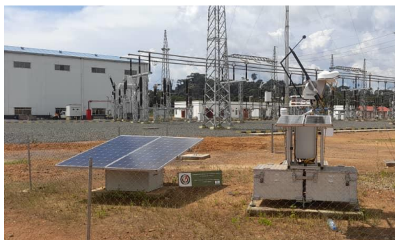
Figure 77: Vue d'ensemble de la station de mesure / Measurement station overview.
