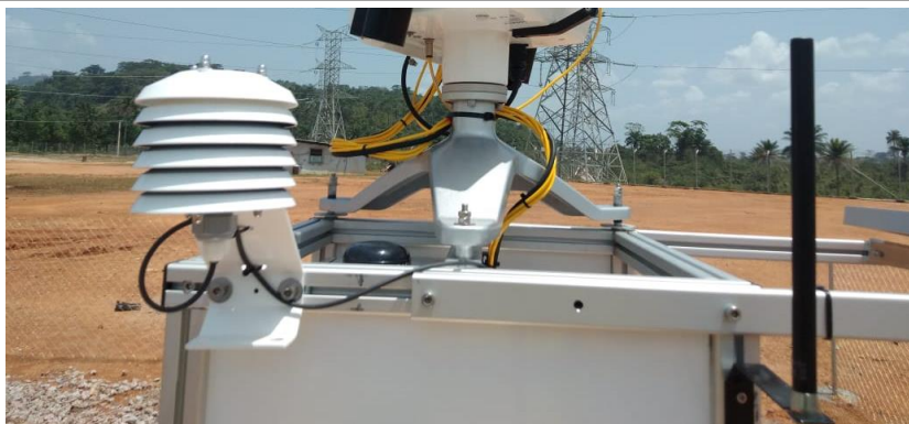
Figure 64: Capteur T/RH et antenne du modem / T/RH sensor and modem antenna.
