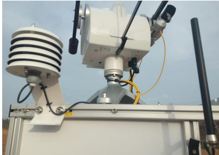
Figure 64: Capteur T/RH et antenne du modem / T/RH sensor and modem antenna.
