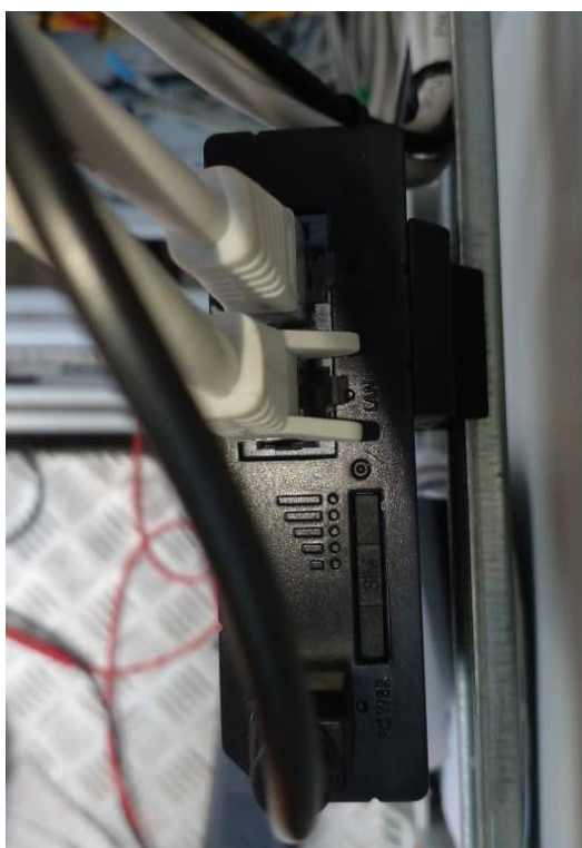
Figure 94: Vérification du bon fonctionnement du routeur LTE / Check of correct operation of LTE router.
