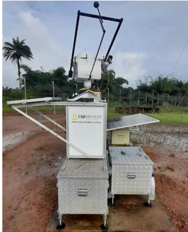
Figure 90 : Structure de montage, tracker solaire, capteurs et boîtier de contrôle / Mounting structure, solar tracker, sensors and control box.
