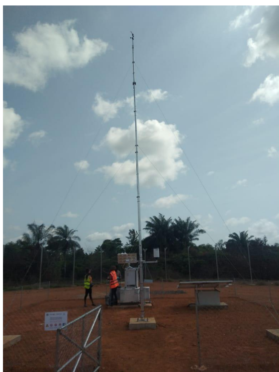
Figure 50: Mât du vent installé capteur de direction du vent orienté vers le nord / Wind mast erected; wind direction sensor orientated to north.
