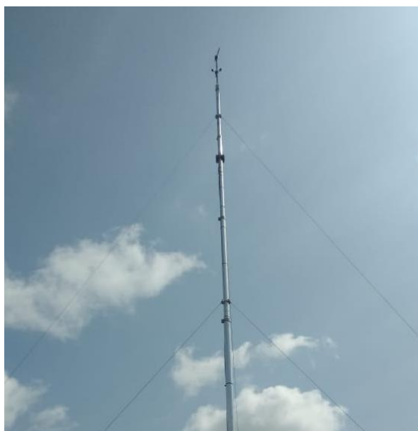
Figure 49: Capteurs de vent installés sur le mât du vent / Wind sensors installed on wind mast.
