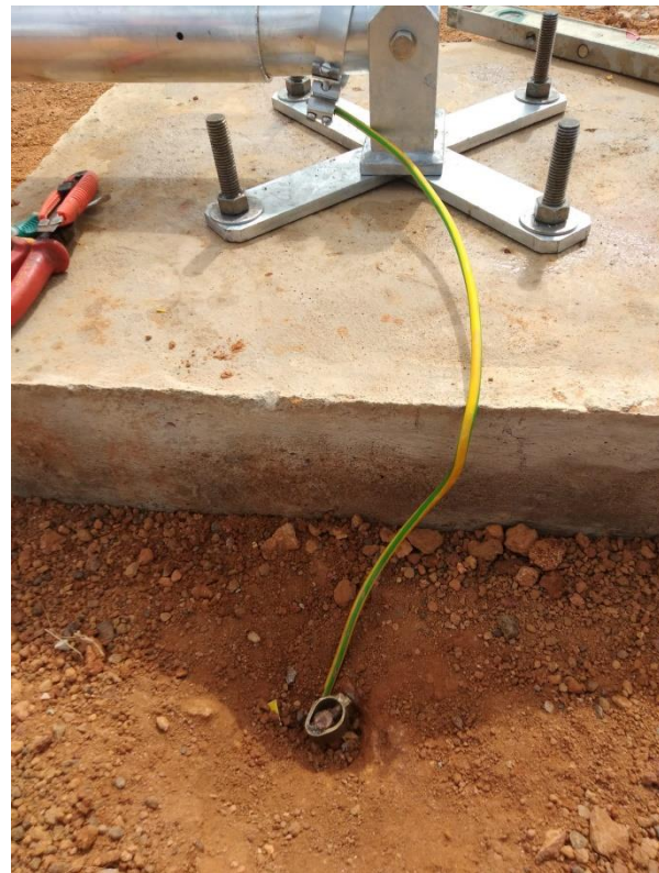
Figure 47 : Fondations du mât du vent, câble de terre fixé au boulon de terre, tube de protection pour les câbles du mât du vent / Wind mast foundations, ground cable fixed to ground bolt, protective tube for wind mast cables.
