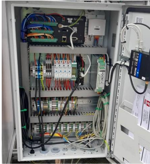
Figure 88 : Intérieur de l'armoire principale / Interior of main cabinet.
