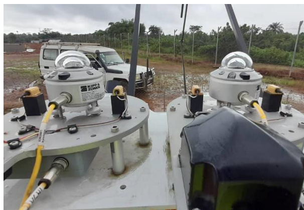
Figure 78: Pyranomètres et ventilations sur le tracker solaire / Pyranometers and ventilation units on solar tracker.
