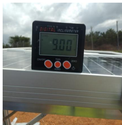
Figure 68: Structure de support PV-S avec un angle d'inclinaison de 9° vers le sud / PV-S support structure with 9° tilt angle towards south.
