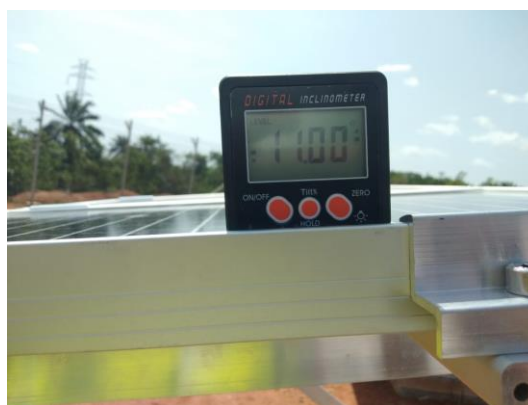
Figure 33: Structure de support PV-S avec un angle d'inclinaison de 11° vers le sud / PV-S support structure with 11° tilt angle towards South.
