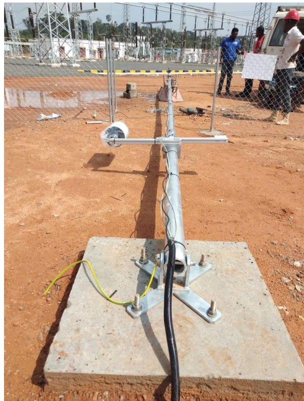
Figure 12 : Fondations du mât du vent, câble de terre fixé au boulon de terre, tube de protection pour les câbles du mât du vent / Wind mast foundations, ground cable fixed to ground bolt, protective tube for wind mast cables
