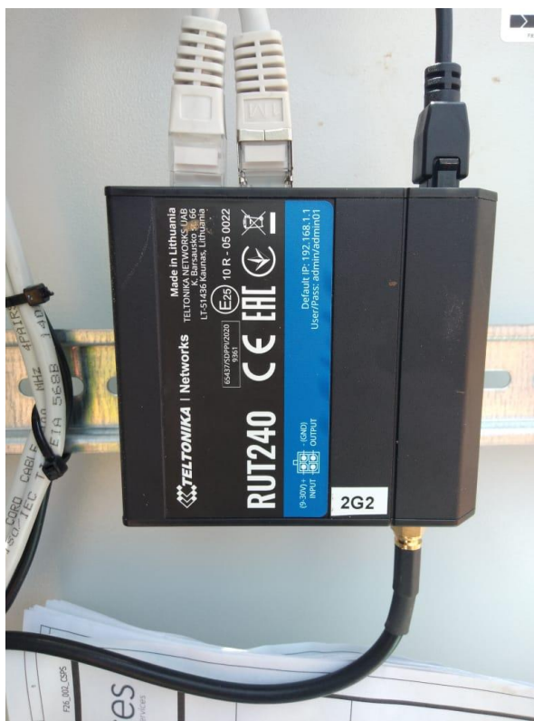
Figure 31: Routeur LTE / LTE router
